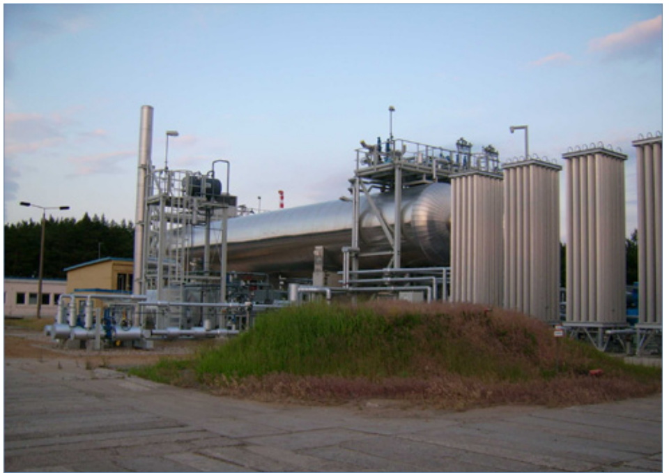
Genehmigungsstreit dauert an: Injektionsanlage Altmark.
